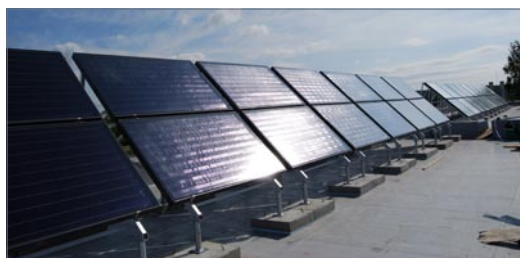
Les panneaux solaires thermique du BTC
