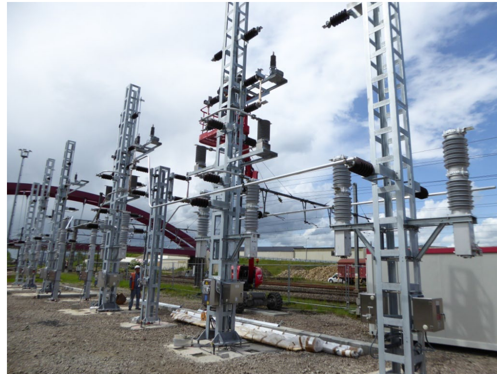
Poste de distribution 303 à Luxembourg-Hollerich
