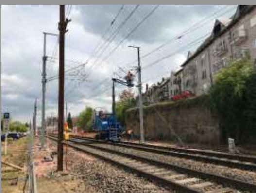
Nouveaux poteaux caténaires
