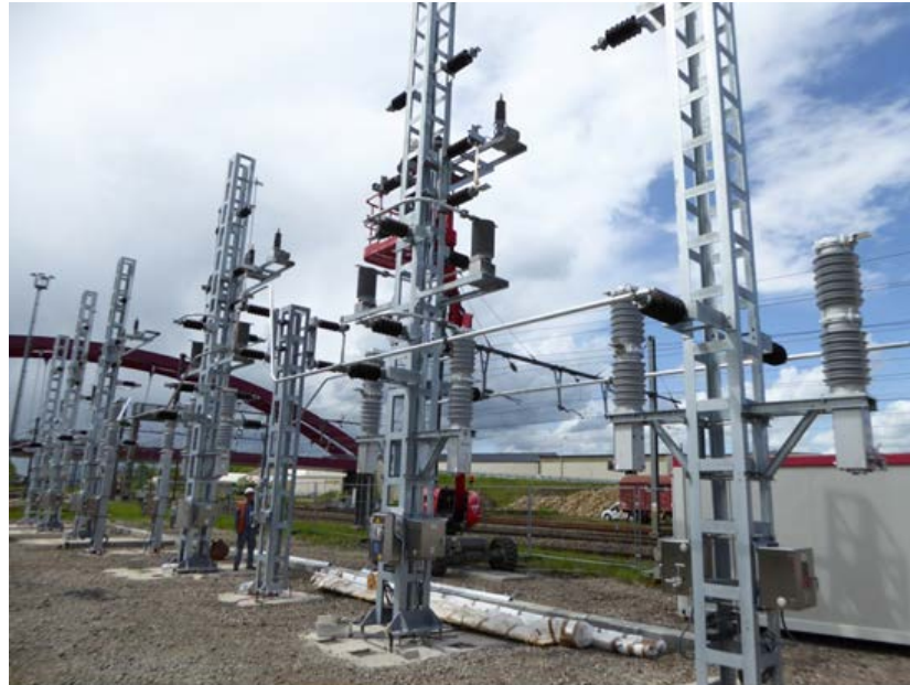
Poste de distribution 303 à Luxembourg-Hollerich
