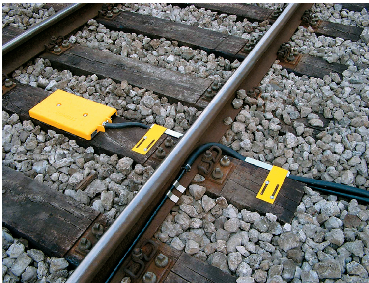
Point d'information ERTMS/ETCS (balise) monté dans la voie.
